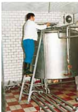
Bild 31: Leiter mit Einhängenvorrichtung am Behälter
